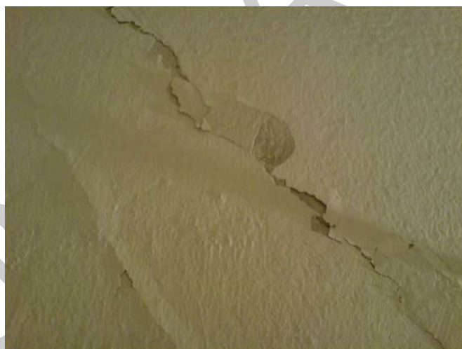
10. ábra. Repedés a falon
