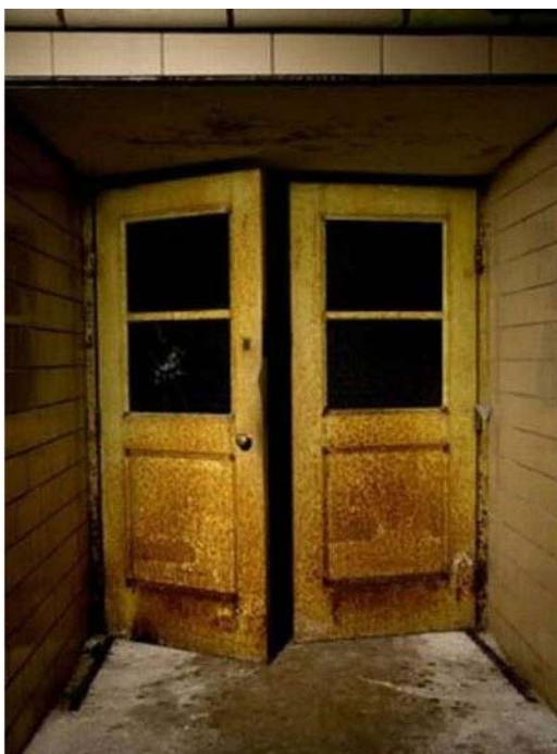
19. ábra. Elhanyagolt rozsdás ajtó 13
