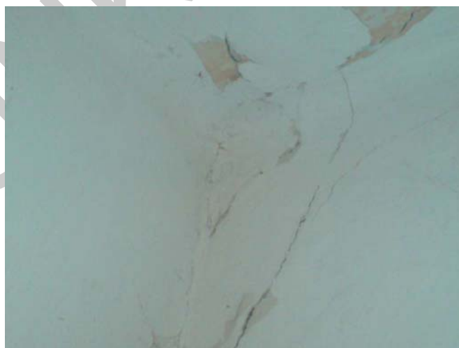
9. ábra. Repedések a sarokban
