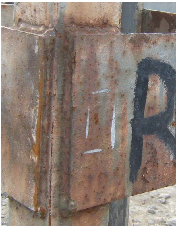
2. ábra. Felújításra váró rozsdásodott acélfelület
