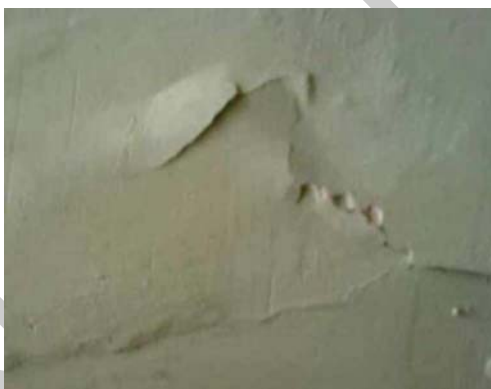
28. ábra. Táskásodott falfelület
