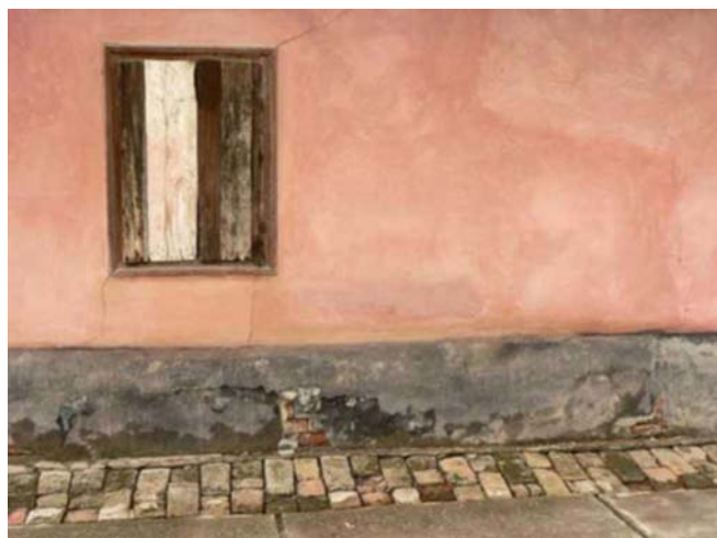
3. ábra. Málladozó lábazat 3
