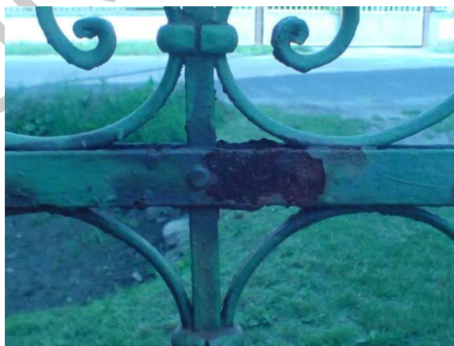
21. ábra. Rozsdás kerítés
