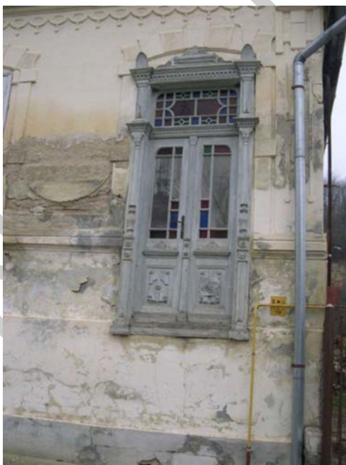
2. ábra. Lepusztult homlokzat 2
