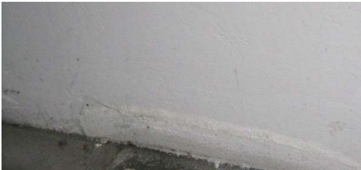
6. ábra. Vakolat elszíneződés 6
