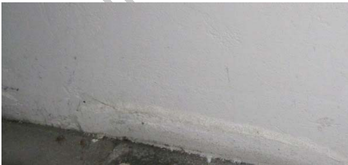
5. ábra. Só kivirágzás a vakolaton 5
