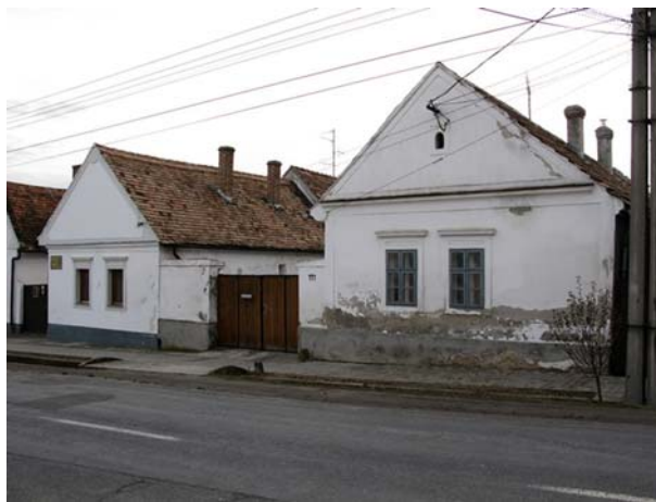
9. ábra. Fertőrákosi lakóház felvizesedett homlokzati fala, sókivirágzással
