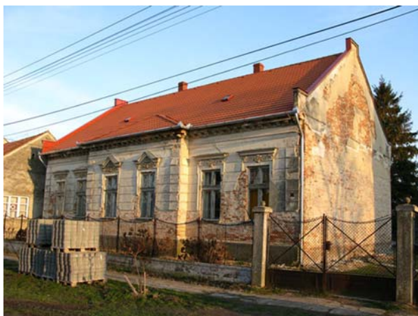
3. Ábra. A Győr–Moson–Sopron megyei Szilsárkány egy lakóháza, az utcai részen részben levert vakolattal, de az északi oldalon az elkorrodálódott vakolattal
