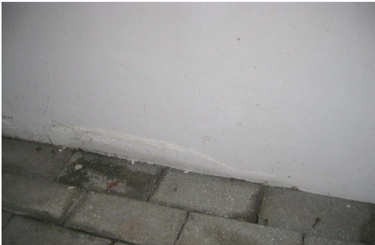
9. ábra. Só kivirágzás a vakolaton 9
