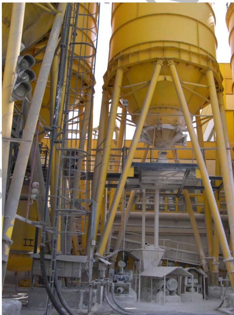
12. ábra. Cementsilók a pórusbeton-gyártás helyszínén
