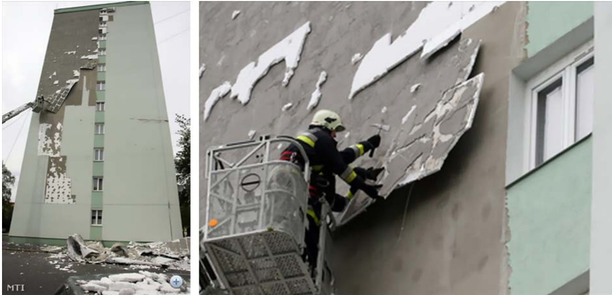
5. ábra. Megtépázott homlokzati hőszigetelés 2
