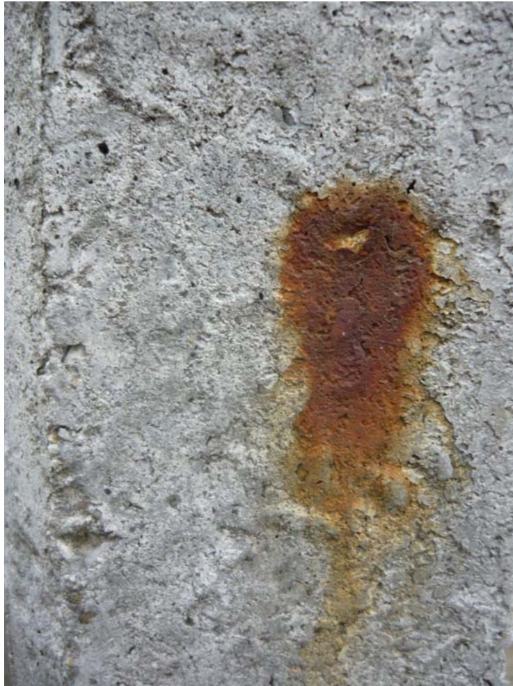
5. ábra. Korrózióból eredő foltosodás
