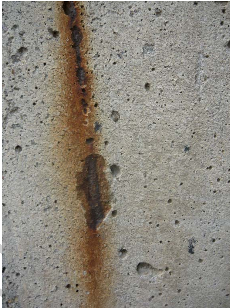
2. ábra. Vasbetonszerkezet, a felületen megjelenő vasalással
