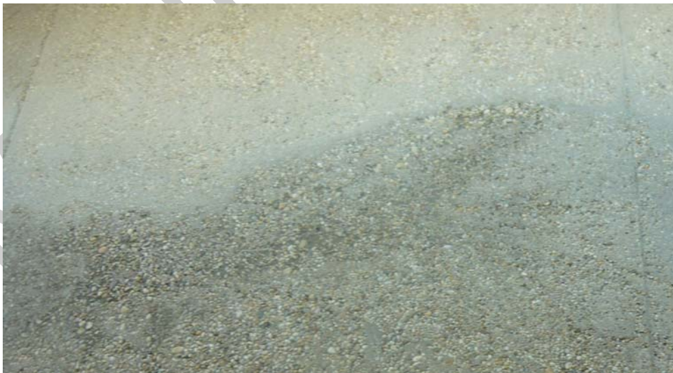
6. ábra. Felületi foltosodás látszóbetonon
