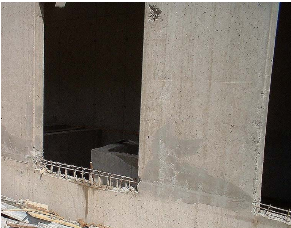
1. ábra. Hibás adatok vagy figyelmetlen tervolvasás miatt a szerkezetben a nyílás nem a megfelelő helyre került. Kizsaluzást követően a szerkezetet vésni kell, a betonvasakat el kell vágni, és a betonfelületet javítani kell.
