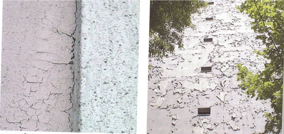
5. ábra. Homlokzati repedésképződés, illetve a színvakolat teljes tönkremenetele 3
