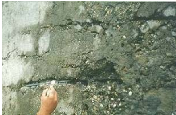
1. ábra. Vasbeton szerkezetek károsodása
