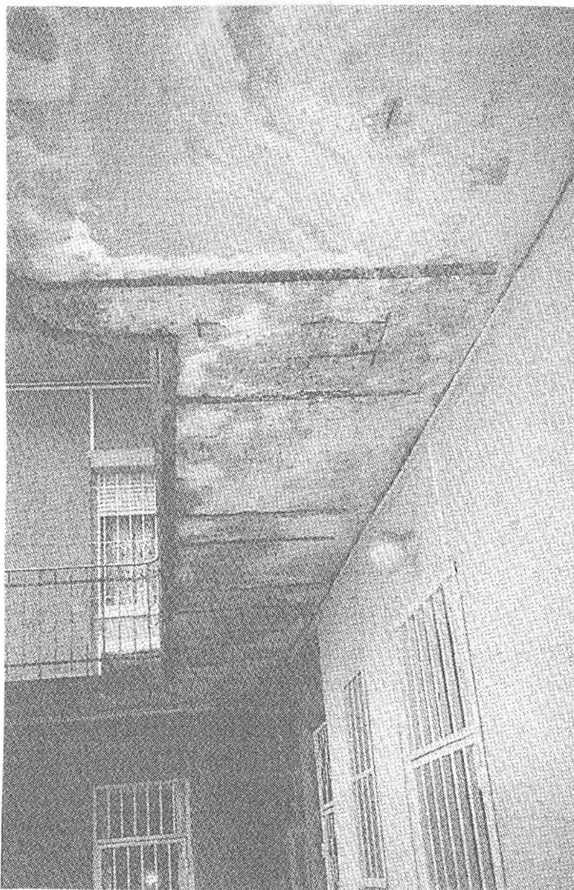
9. ábra. Acélgerendás függőfolyosó tartós átázásának következményei: revés rozsdásodás, vakolathullás, betonanyag elmállása, felületi részek kagylós kiszakadása 9
