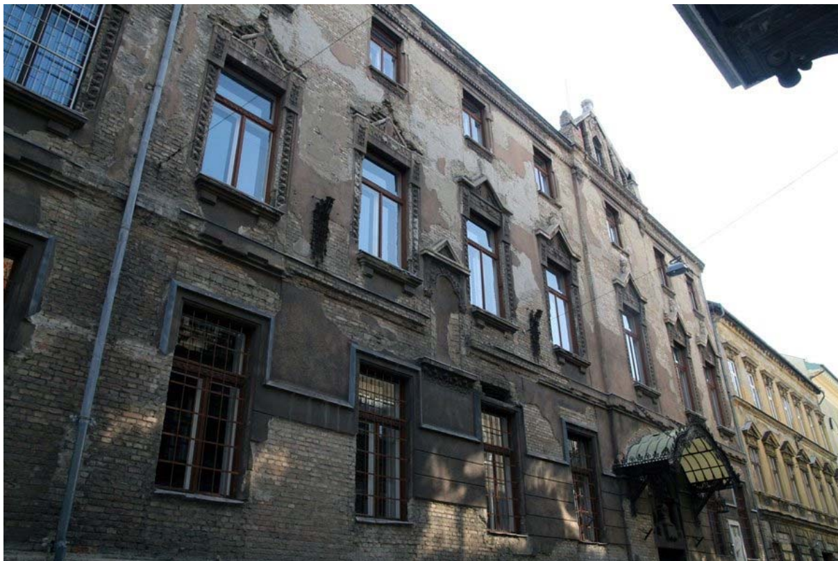
4. ábra. Lepusztult, felújításra szoruló homlokzat 4
