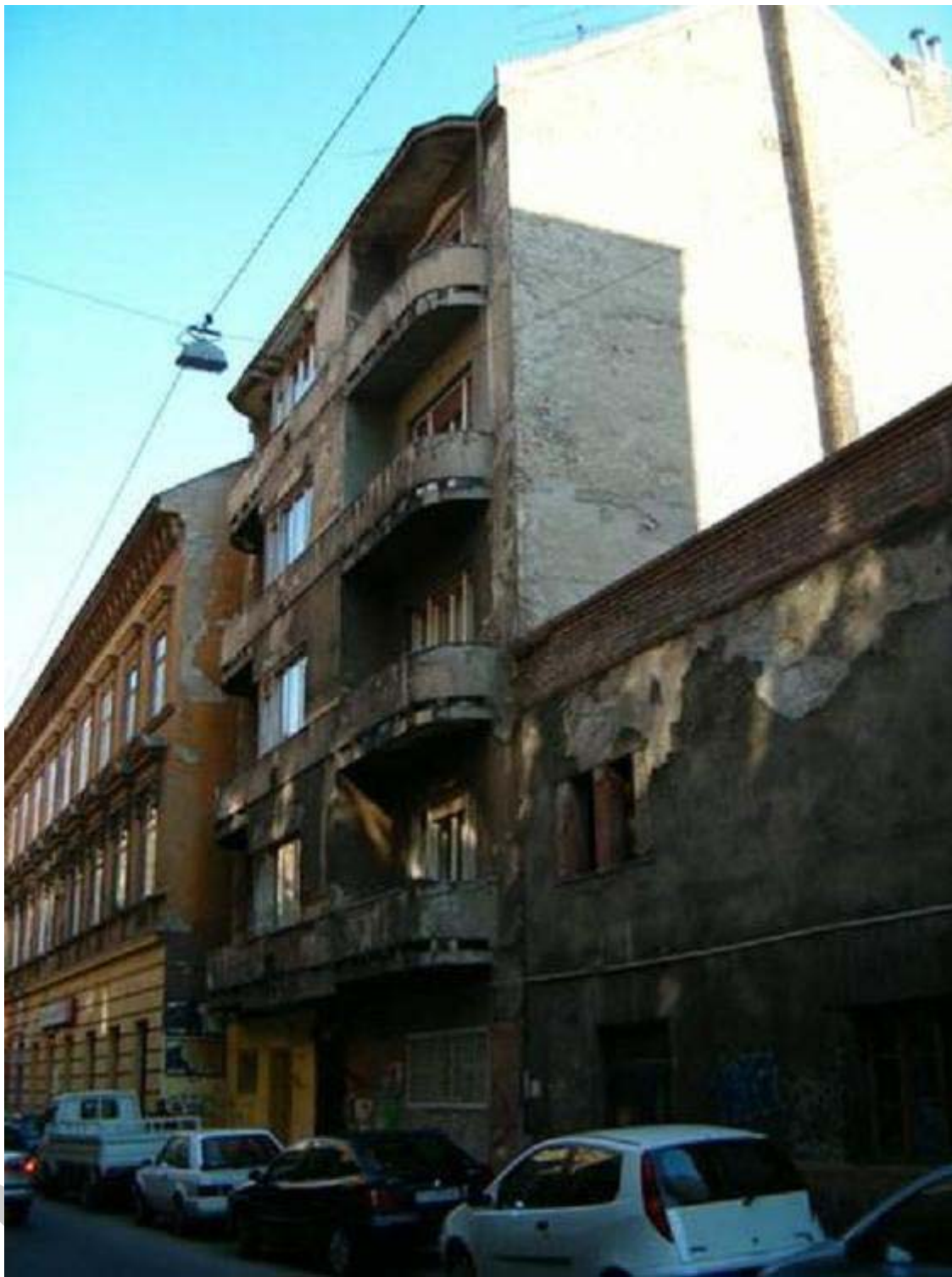
1. ábra. Paulai Ede utca 49., elhasználódás következtében kialakult homlokzati károsodás 1
