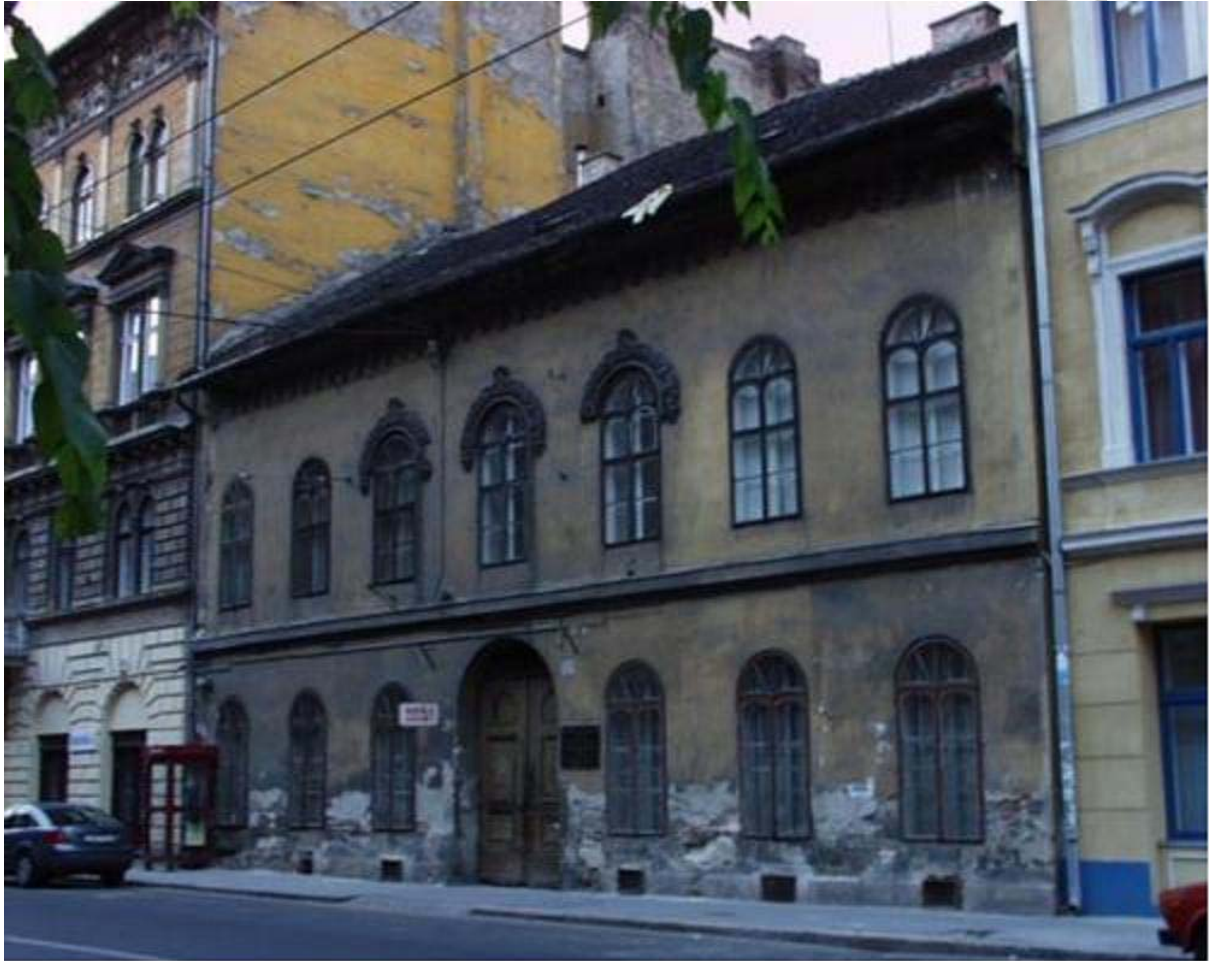
8. ábra. Budapesti, Baross utcai épület károsodott homlokzata 5
