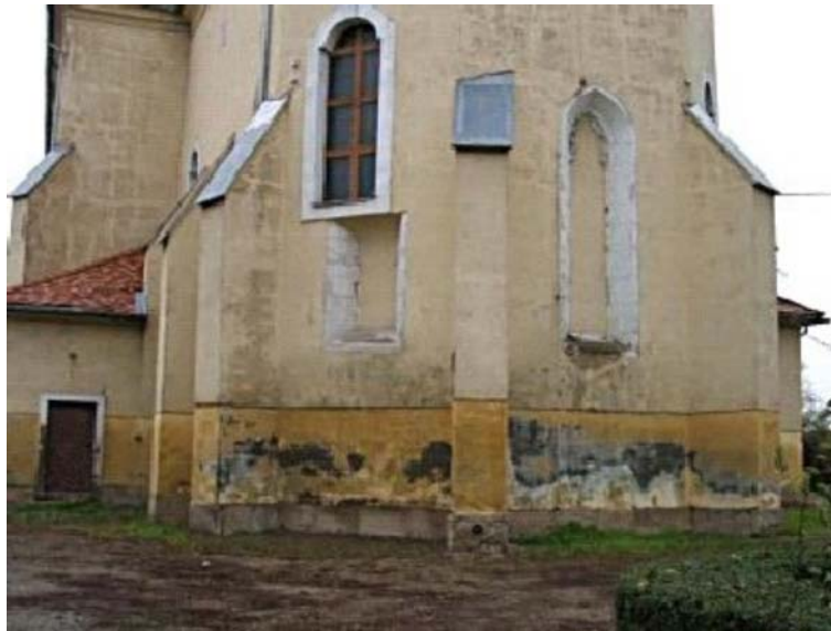
2. ábra. Nedvesség okozta kár épületben 2
