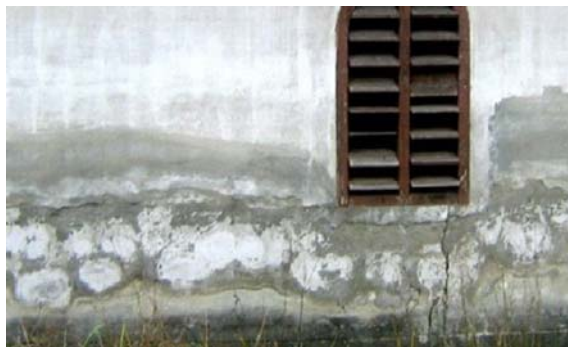
13. ábra. A falszerkezetbe felszivárgó nedvesség 13
