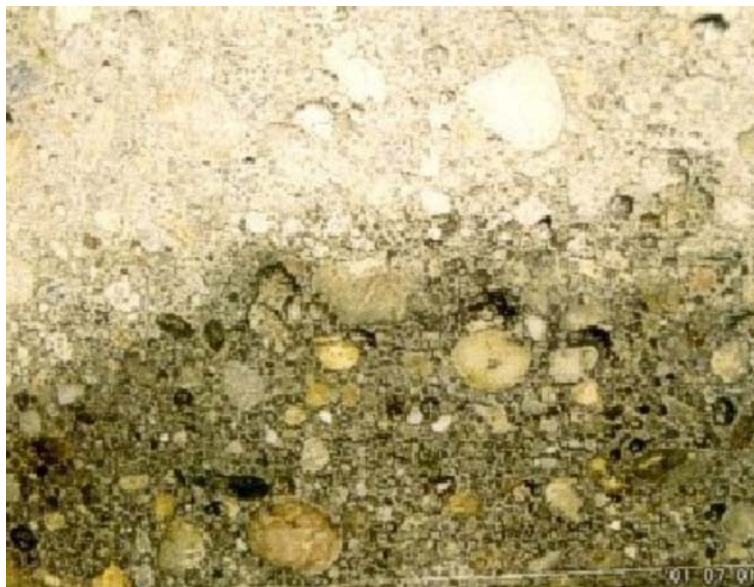
4.ábra. A víz jelenléte beton szerkezetben 4
