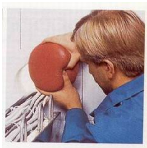
9. ábra. Tűzgátló dugó 6
