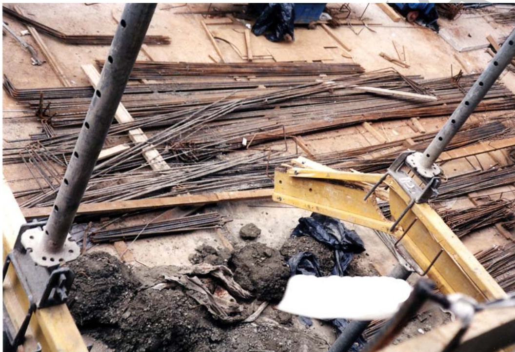
22. ábra. Betonozáskor a hibásan megépített zsalu nem bírta a terhelést 24
