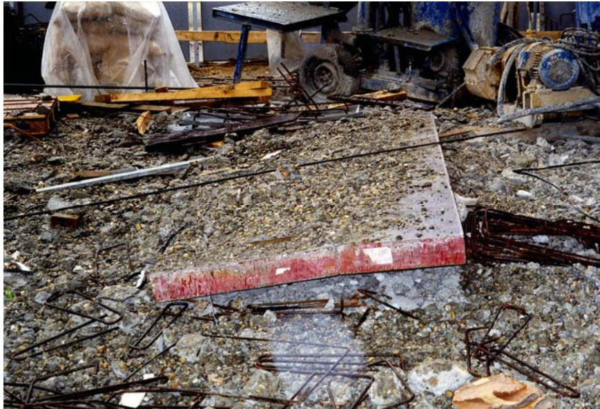
26. ábra. A törmelék alá került, deformálódott zsalutábla használhatatlan 28
