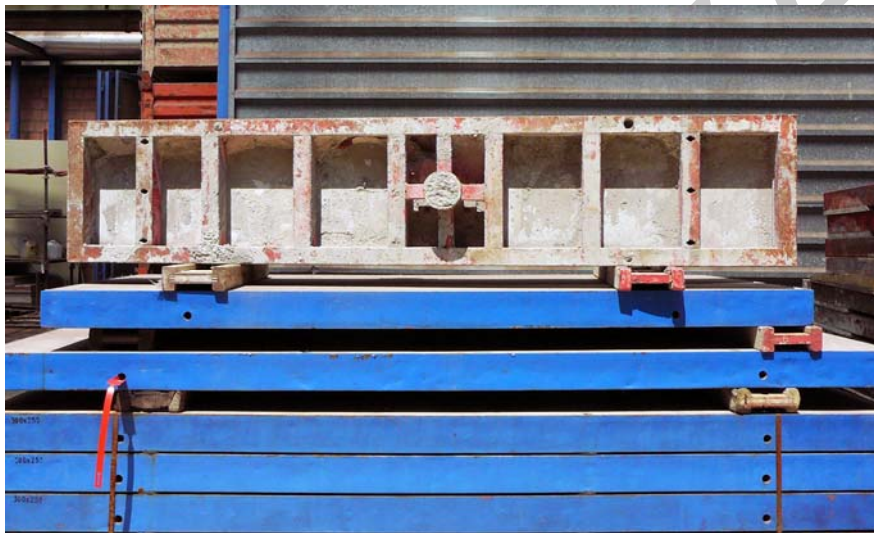
6. ábra. A betonozó nyílásban bent maradt, megszilárdult a beton 6
