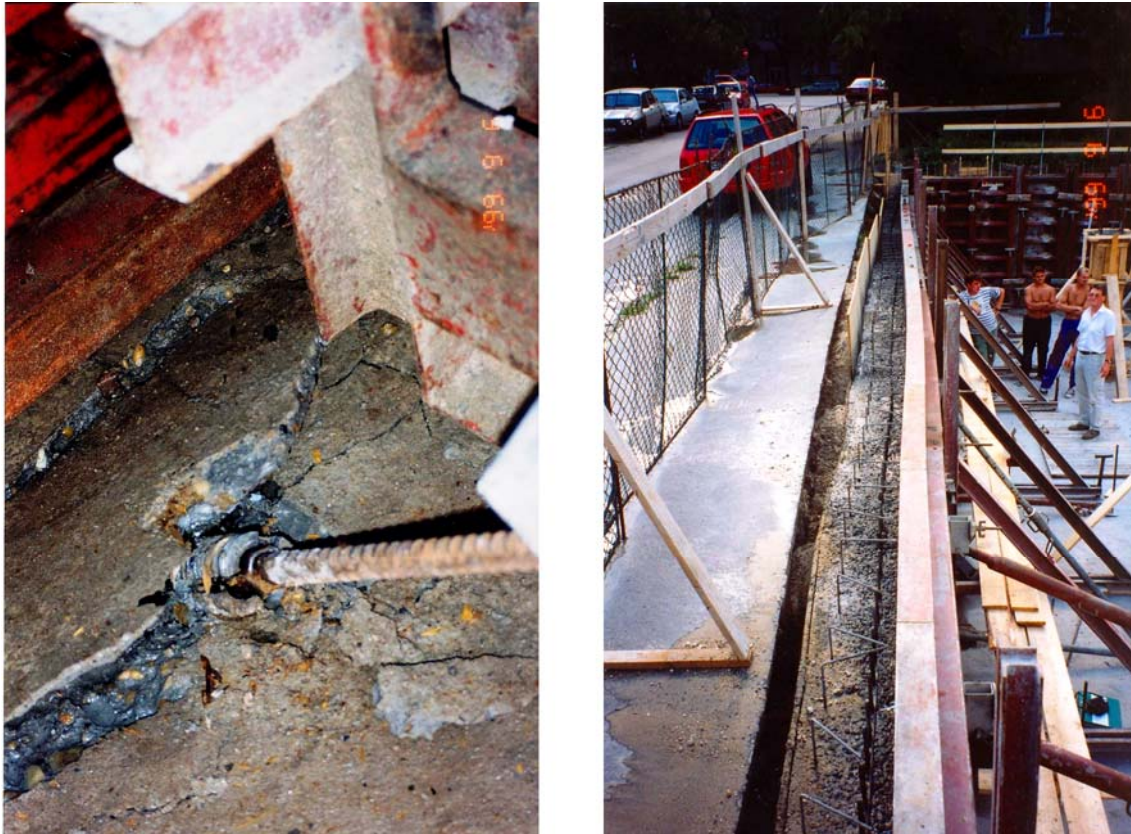
32. ábra. Egyoldali falzsaluzatot rögzítő elem kiszakadása, és annak következménye 34
