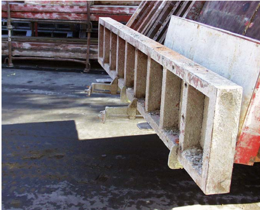
4. ábra. A keretek közé és a zsalukapcsokra is bőven jutott beton 4
