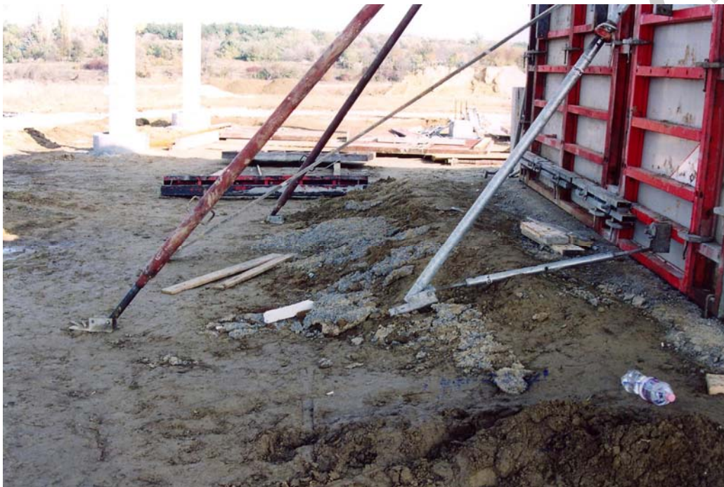
21. ábra. Oldaltámaszok helytelen alsó rögzítése 23
