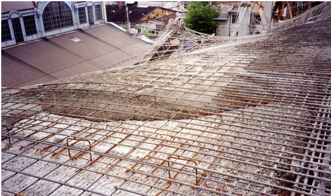
23. ábra. A szakszerűtlen födémszerelés eredményezte a födémmező leszakadást 25
