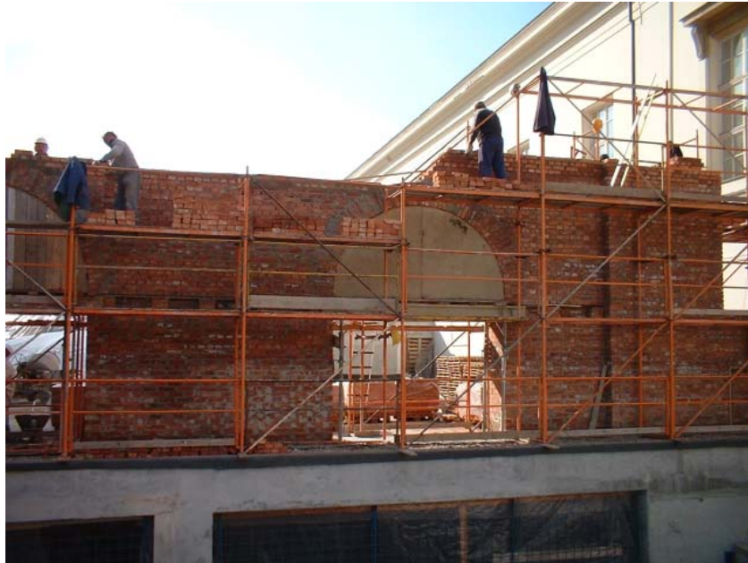
1. ábra. Kőműves munka megfelelő védelem nélkül
