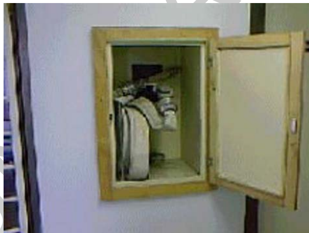
2. ábra. Fali tűzcsap
