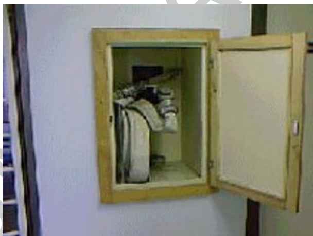
23. ábra. Fali tűzcsap
