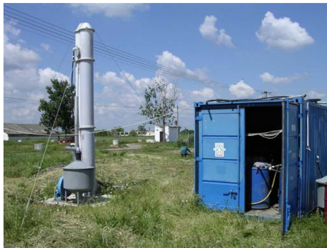
6. ábra Sztrippelő torony (ellenáramú átlegeőztető) és talajvíztisztító konténer
