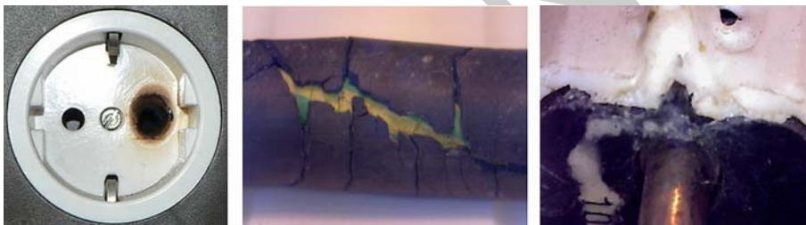
2. ábra. Szigetelési hibák
