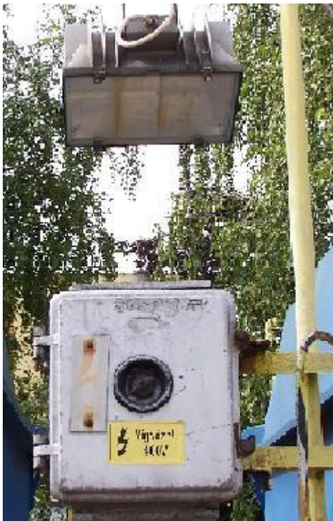
10. ábra. Falon kívüli, időjárásnak kitett tokozott kapcsolókészülék
