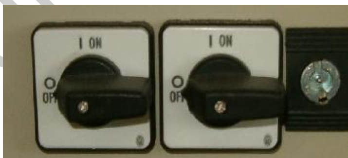
11. ábra. Beépített kapcsolókészülékek
