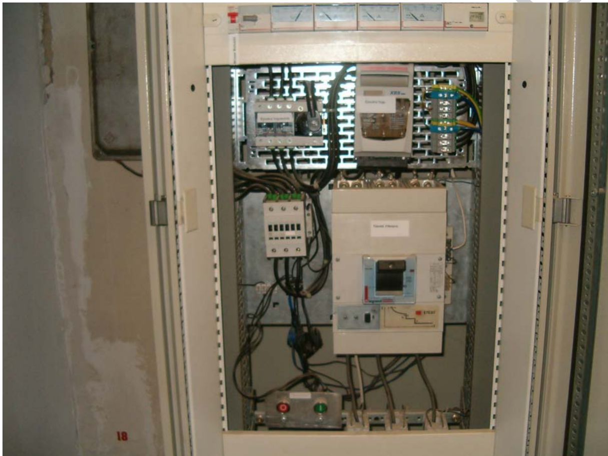
1. ábra. Világítási főelosztó
