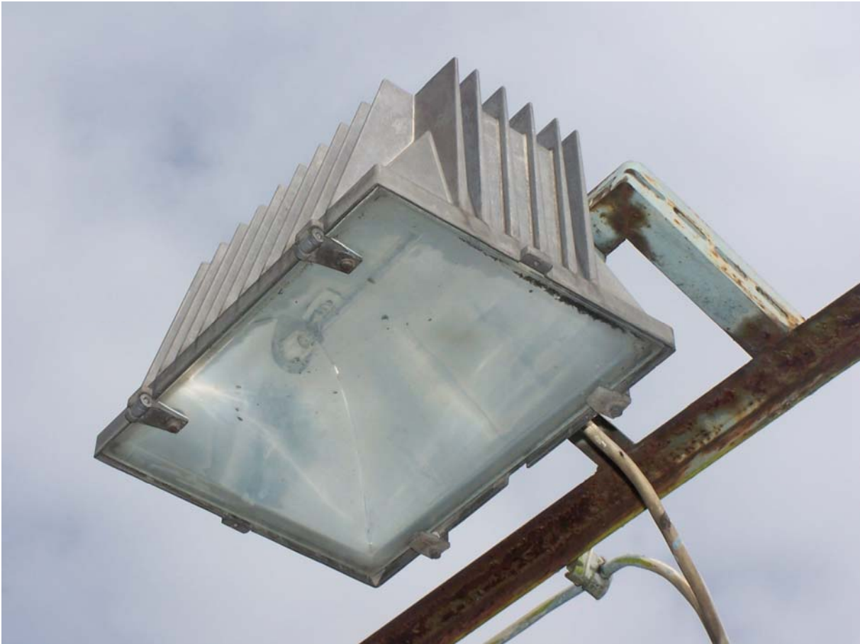
34. ábra Külső fényforrás kiépítése
