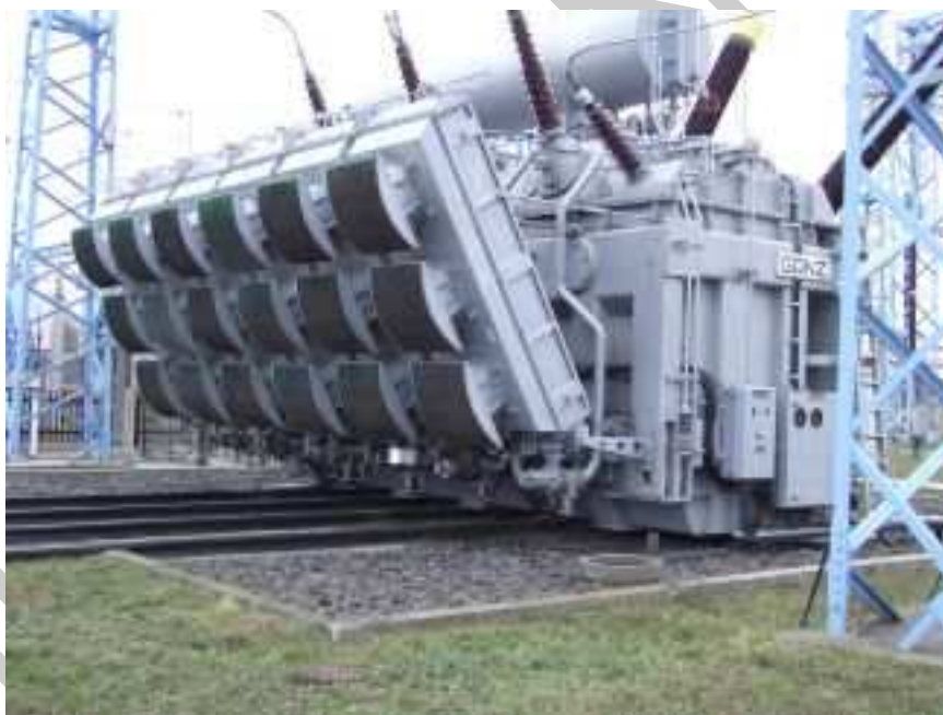
10. ábra. A győri OVIT Állomás 400 kV-os transzformátora
