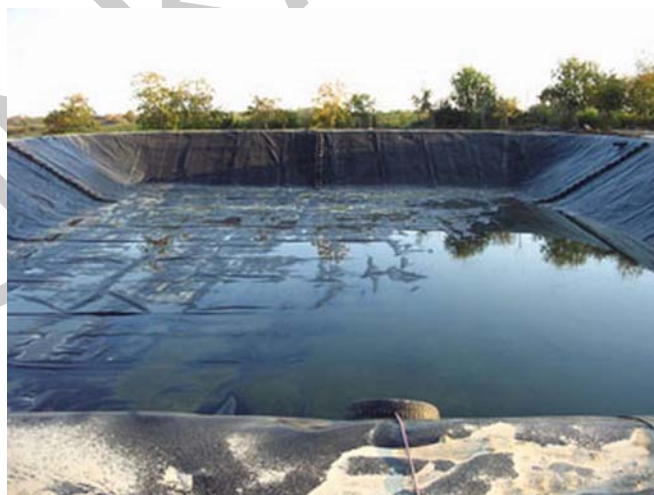
7. ábra. HDPE fóliával bélelt hígtrágya tároló medence 12
