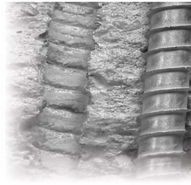
15. ábra. Betoncsavarok fellépő korrózió
