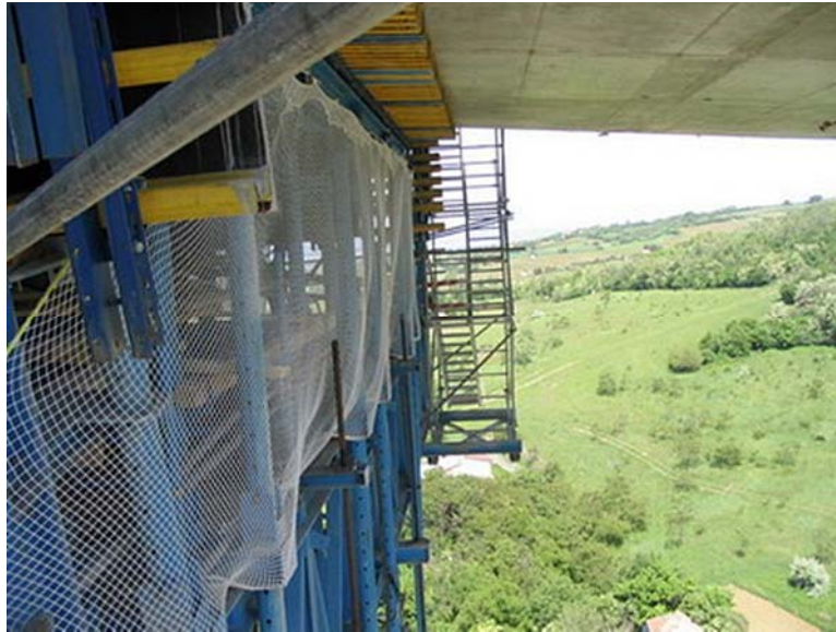
23. ábra. Védőháló hídépítésen 23
