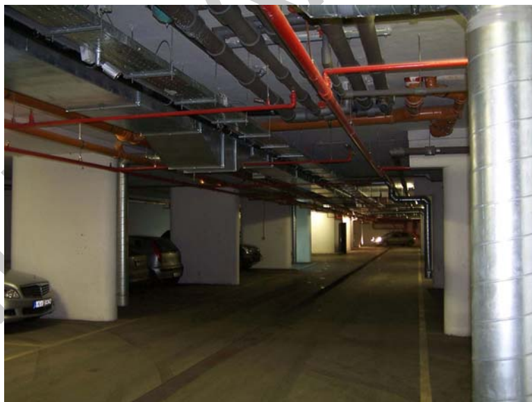
7. ábra. Sprinkler rendszer mélygarázsban 7
