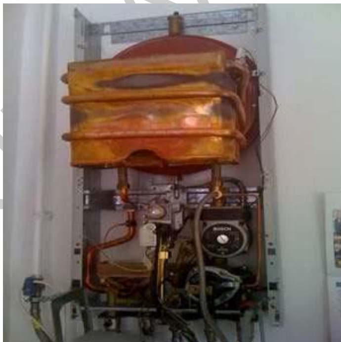
1. ábra. Fali elhelyezésű kazán burkolat nélkül
