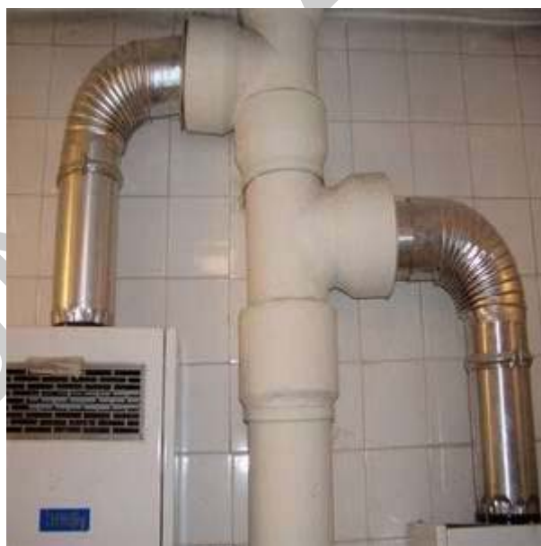
2. ábra. Szabálytalan szerelés. Kémény szennyvíz csövekből
