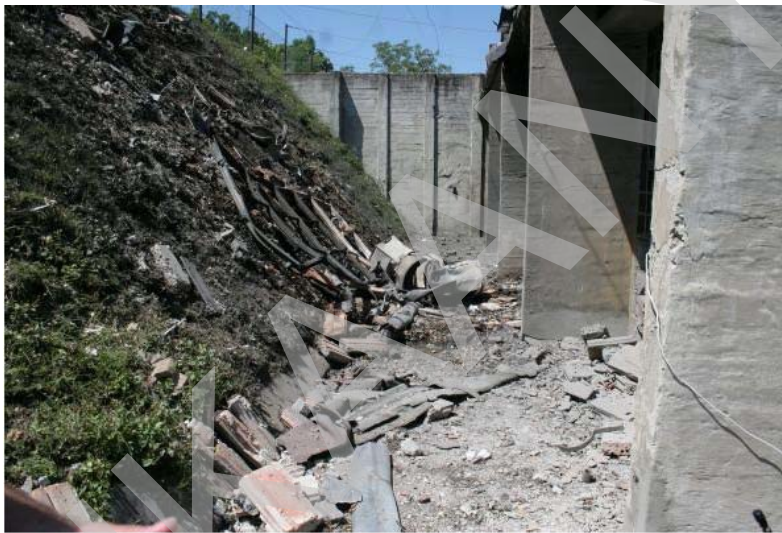
10. ábra Funkcióját ellátó védelmi létesítmény robbanóanyag raktárnál (hasadó-nyíló fal és védősánc)
