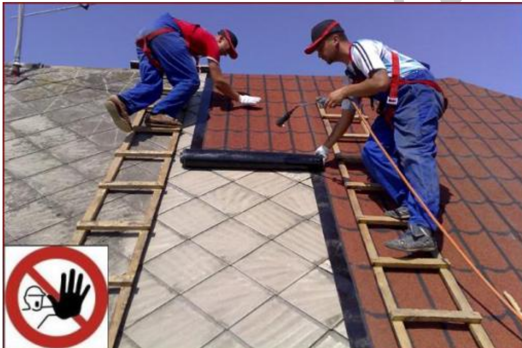
34. ábra. Egészséget veszélyeztető munkavégzés azbeszt tartalmú síkpala tetőn 35
