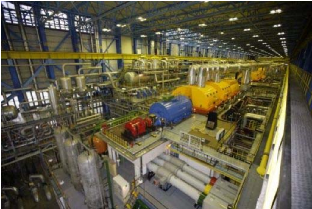
7. ábra. Paksi atomerőmű, turbina csarnok 7
