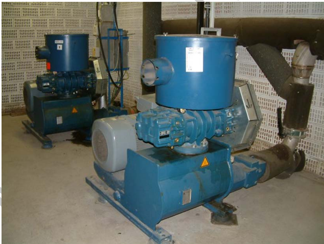
25. ábra Szennyvíz átemelő gépcsoport
