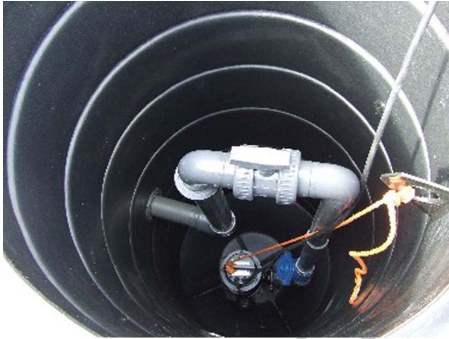
24. ábra Közepes teljesítményű szennyvíz átemelő
