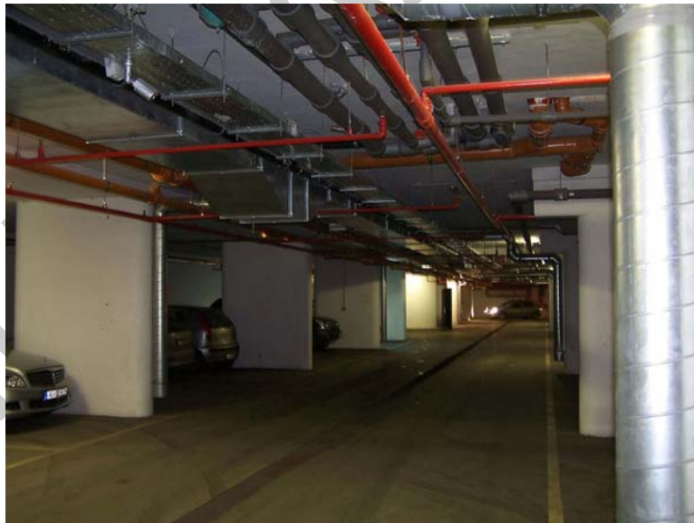
7. ábra. Sprinkler rendszer mélygarázsban?
