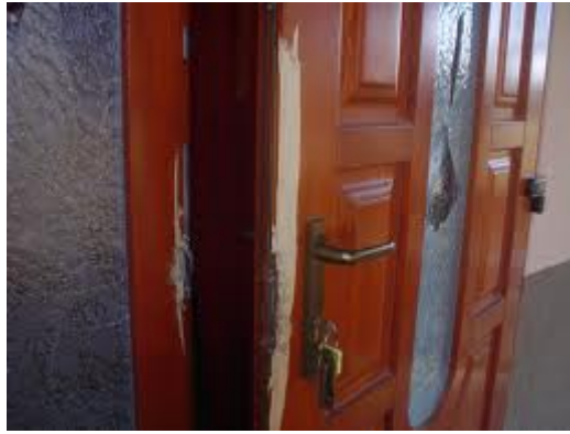
3. ábra. Broken door
