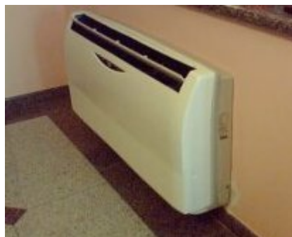
6. ábra. Oldalfali parapetes klíma 7
