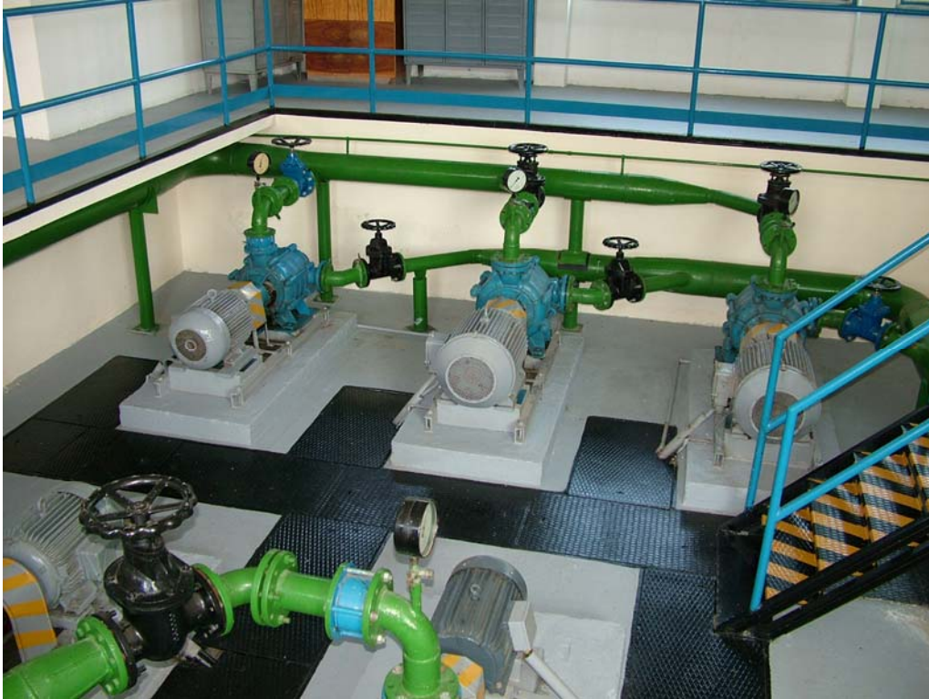
2. ábra. Ivóvízhálózat nyomásfokozó berendezései
