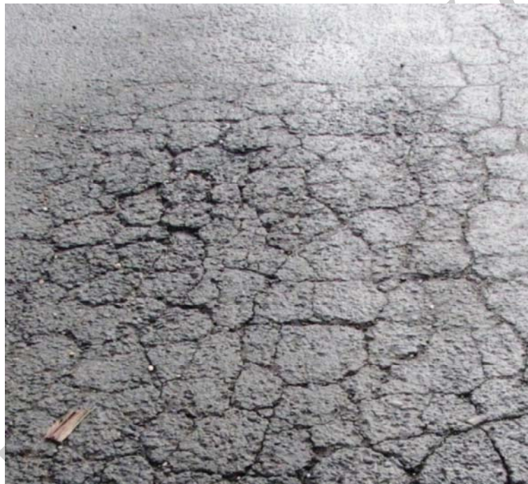
2. ábra. Mozaikos repedés
