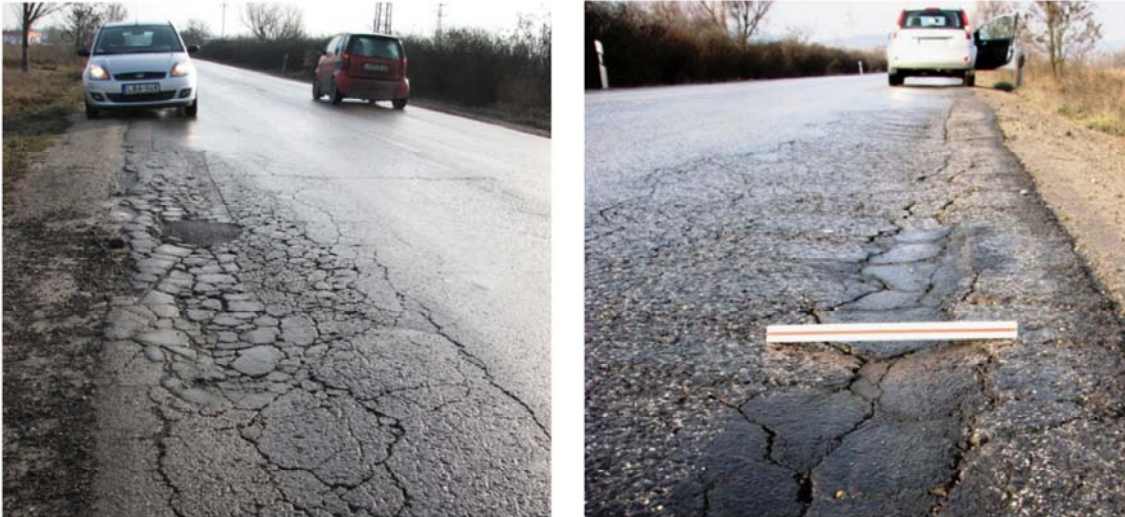
3. ábra. Szabálytalan repedésrendszer megsüllyedt pályaszerkezeten
