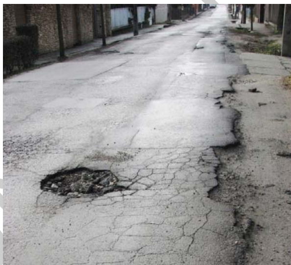
1. ábra. Leromlott aszfaltburkolatú utak jellegzetes hibái
