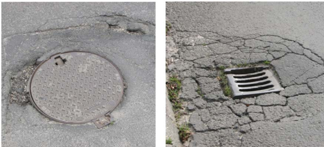
9. ábra. Közmű szerelvények csatlakozási hibái az aszfaltburkolaton
