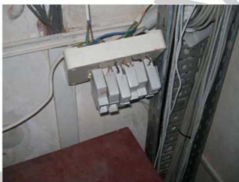
1. ábra. Az elhanyagolt elektromos berendezések fokozott kockázatot jelentenek 1
